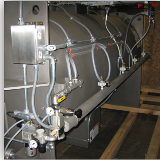
Colector de aire comprimido para sellos y válvula de descarga, y caja de conexiones de acero inoxidable NEMA 4x para componentes onofásicos
